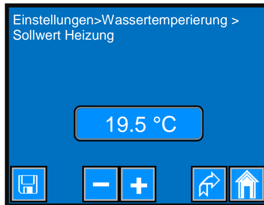
Bild 9: Einstellung des Sollwertes der Heizung
